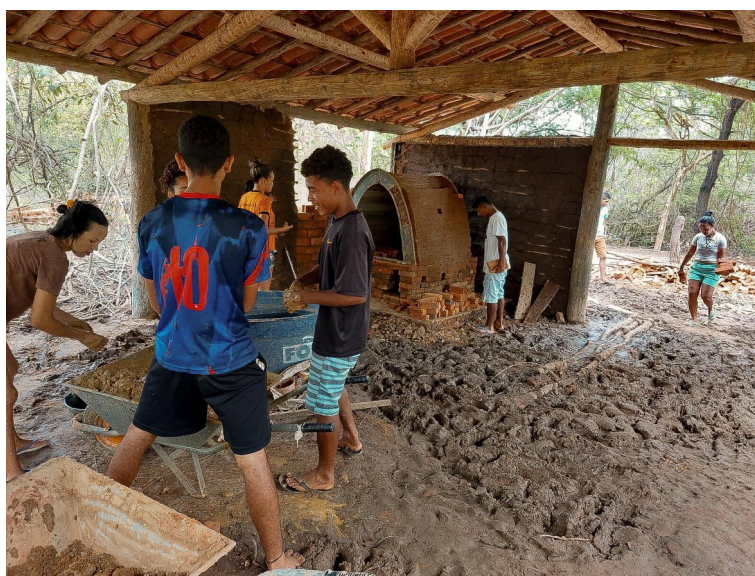
Figura 3: Alunos do ensino médio dando continuidade a construção da Casa do Forno.
