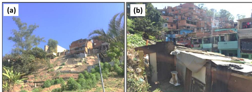
Figura 2 – Exemplos de evidências encontradas nos setores mais críticos: (a): moradias muito próximas ao topo da encosta e árvores inclinadas atingindo medidas de contenção (setor 1) e (b): moradias muito próximas à base da encosta (setor 6).
