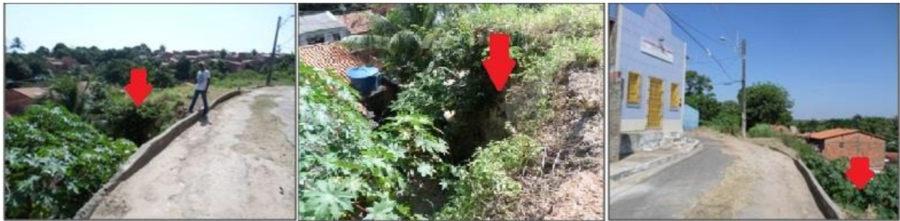
Figura 4: Área com ocorrência de movimentos gravitacionais de massa na Rua Santa Tereza, Vila Embratel – Escorregamentos do tipo rotacional
