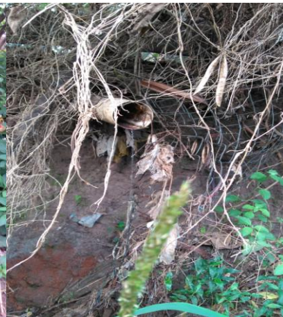
Figura 6: Esgoto de Banheiro
