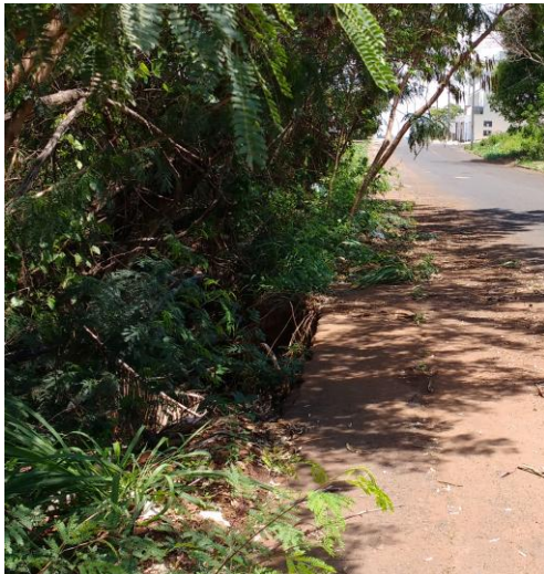
Figura 1: Assoreamento chegando à rua
