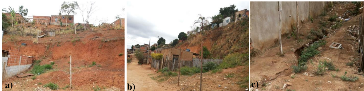
Figura 3 – a) Erosões no taludes. b) Habitações nas bordas e encostas do talude. c) Presença de sulcos.
