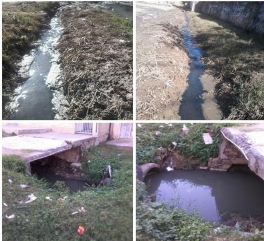
Figura 01: Esgoto a céu aberto, no bairro Cidade Nova em Aracaju
