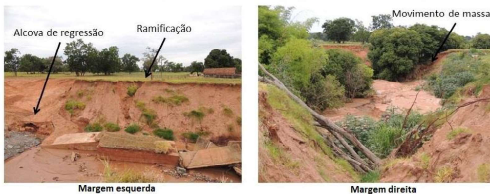
Figura 4 – Mecanismos erosivos encontrados na feição. Fonte: Os autores, 2016.
